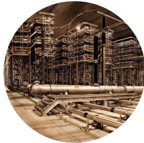
Estación convertora en España
